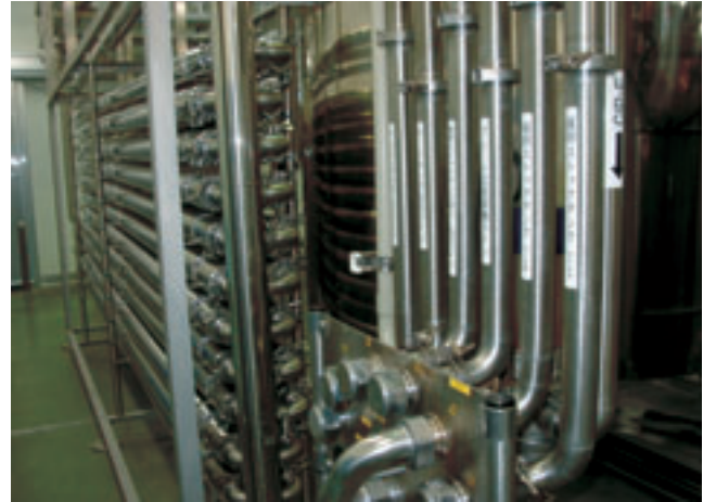
殺菌・冷却・濾過の各装置やタンクを結ぶ配管
